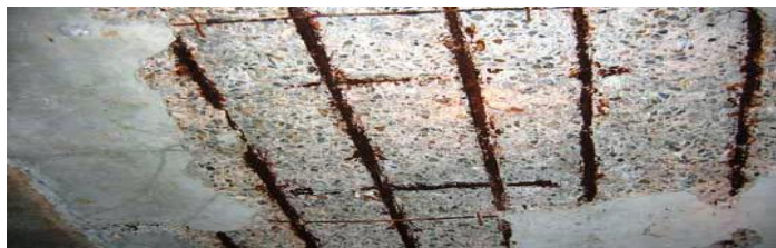
شكل (2-5) يوضح شروخ التآكل الحديد
